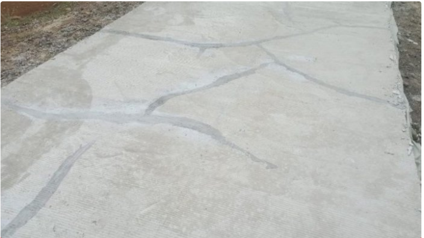
Pekerjaan beton yang belum lama dikerjakan nampak retak
